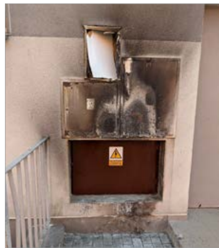
Fot. 1. Skutki pożaru złącza kablowego i rozdzielnic pomiarowo-dystrybucyjnych fot. K. Kuczyński
