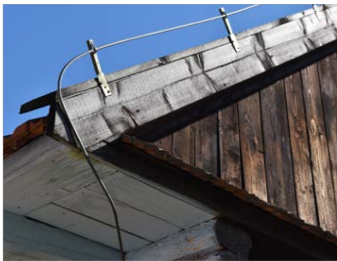
Instalacja formalnie jest. Mimo że grozi pożarem przy wylądowaniu – nikt się tym nie przejmuje
