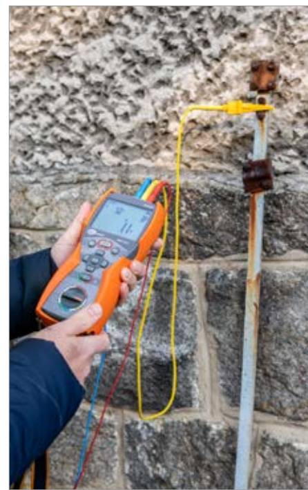
Pomiar rezystancji uziemienia miernikiem Sonel MPI-507
