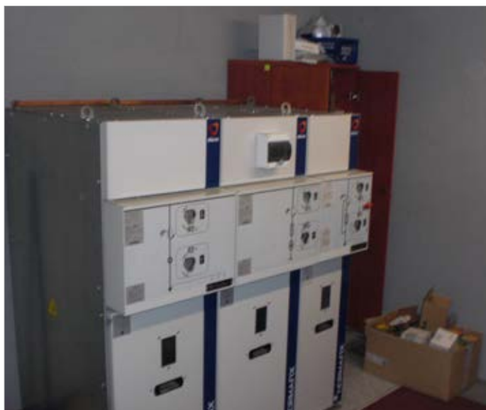
Magazyn obok biura w przedziale SN stacji transformatorowej
