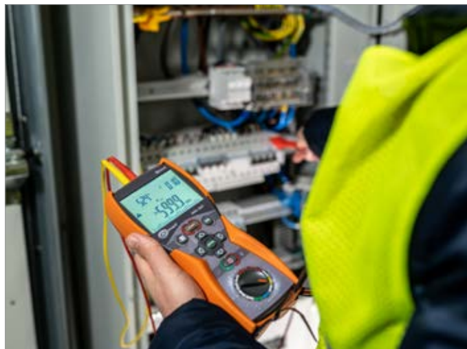
Pomiar rezystancji izolacji miernikiem Sonel MPI-507
