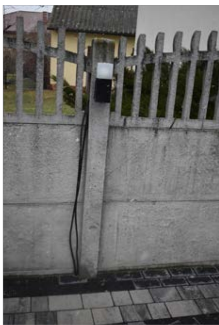
Przewód w II klasie ochronności, więc rura osłonowa zbędna
