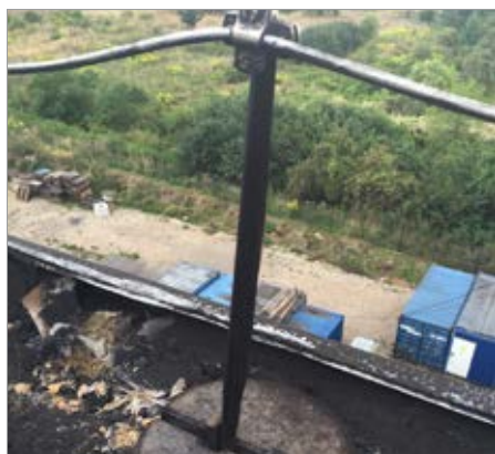
Rys. 3. Obiekt uszkodzony w wyniku niezachowania wymaganych odstępów separacyjnych i niekontrolowanych przeskoków iskrowych od instalacji odgromowej [1]
