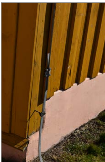
„Doskonałe” odprowadzenie piorunów
