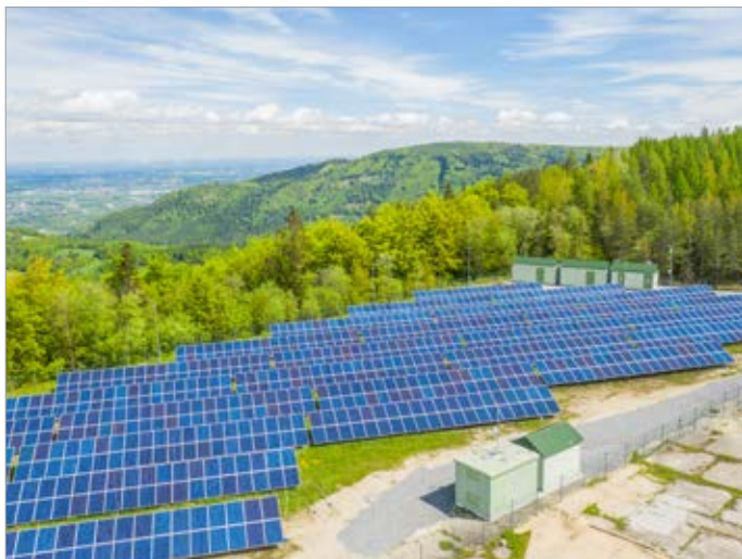
Farma fotowoltaiczna PGE EO na Górze Żar z magazynem energii Impactu i Mysoftu
