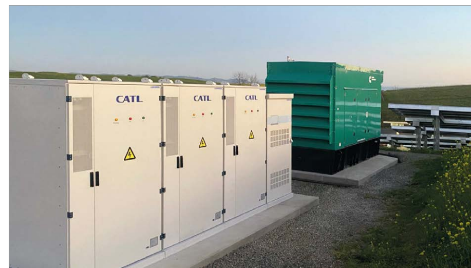
Instalacja Sunsys HES L na wolnym powietrzu
