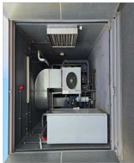
Rys. 3. Z lewej strony widoczna szafa sterująca modulem generatora azotu, zasilana z sieci podstawowej, wraz z zasilaniem gwarantowanym w postaci baterii akumulatorów Źródło: Pfeifer & Langen Polska S.A.
