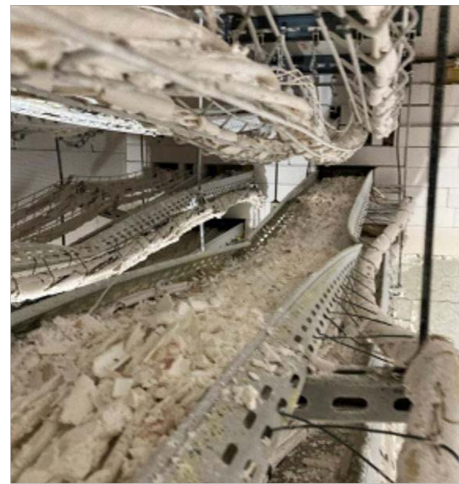
Rys. 2. Zespół kablowy po przeprowadzonym teście wg DIN 4102-12:1998
