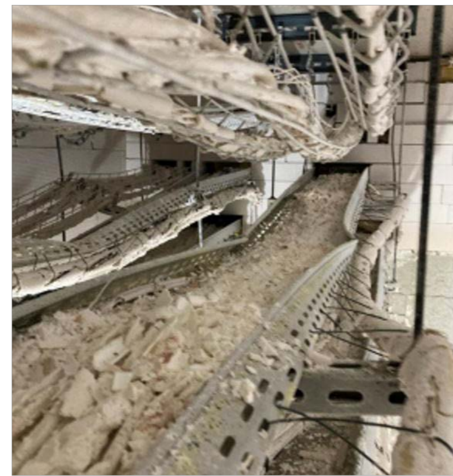
Rys. 2. Zespół kablowy po przeprowadzonym teście wg DIN 4102-12:1998
