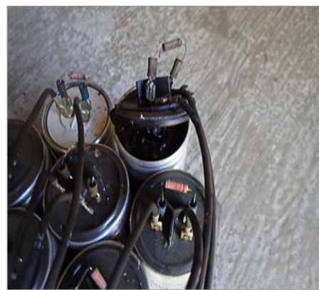
Rys. 7. Widok uszkodzonego kondensatora rys. M. Żebrowski
