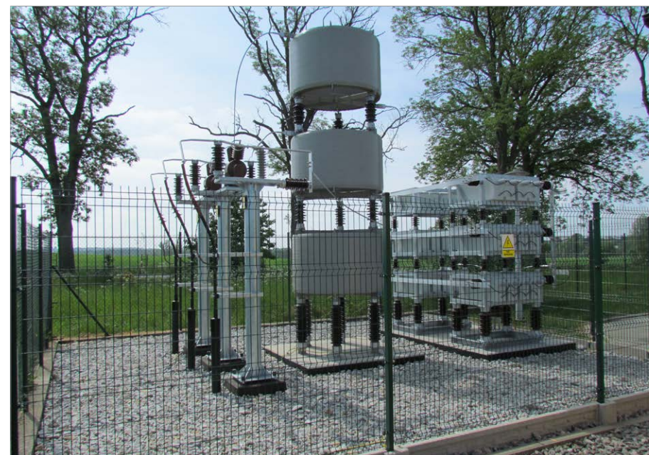
Fot. 1. Tradycyjne urządzenia kompensacyjne – bateria kondensatorów BSND-2yz-30 30kV, 11 MVar
