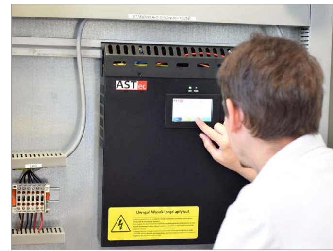
Fot. 1. Widok kompensatora mocy biernej ASTec fot. A. Książkiewicz
