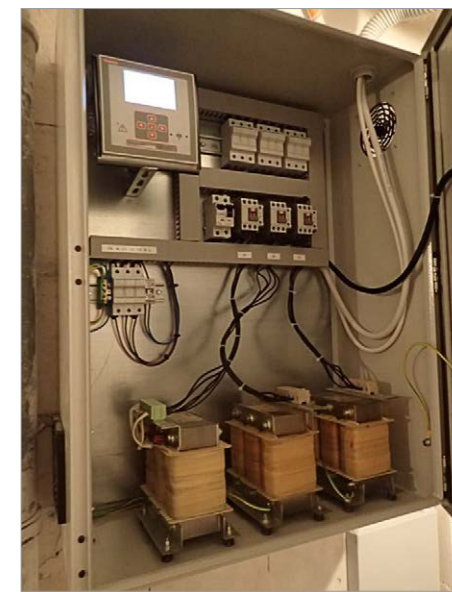
Rys. 4. Przykładowa automatyczna bateria dławików kompensacyjnych rys. M. Żebrowski
