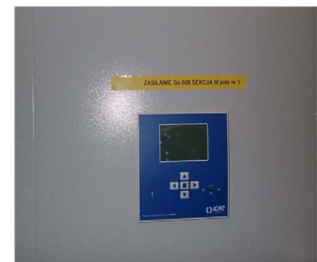
Rys. 5. Widok uszkodzonego regulatora – brak zasilania rys. M. Żebrowski
