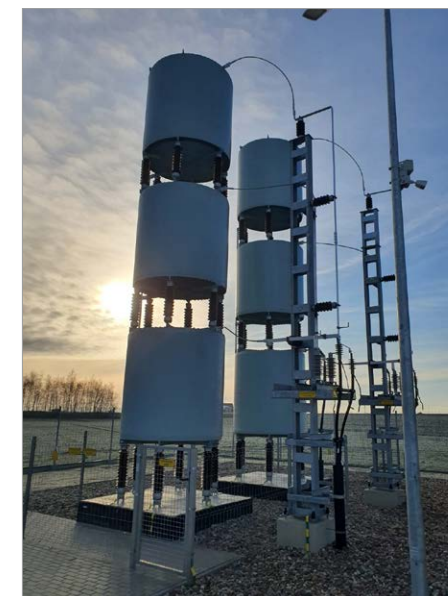
Fot. 2. Tradycyjne urządzenia kompensacyjne – układ dławików kompensacyjnych 4,4 Mvar + 7,75 Mvar/31,5 kV
