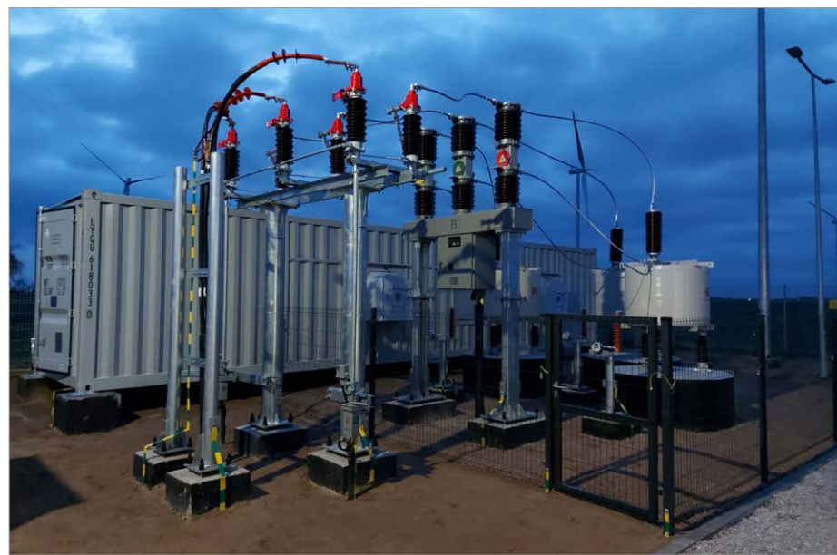
Fot. 3. Układ STATCOM 5,5 Mvar/30 kV
