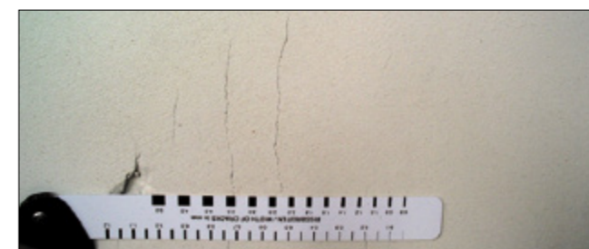
Pomiar szerokości rys po badaniu w komorze klimatycznej za pomocą szczelinomierza po wydłużonym procesie starzenia Fot. SSO
