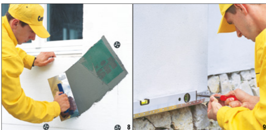
Fot. 6–9. Wybrane etapy prac przy montażu systemów ociepleń: 6 – wspomagające kotwienie, 7–8 – wklejanie siatki (7 – wklejanie profilu w naroże okna, 8 – dodatkowe wzmocnienie siatką strefy przyokiennej), 9 – mocowanie listwy startowej Fot. Henkel
