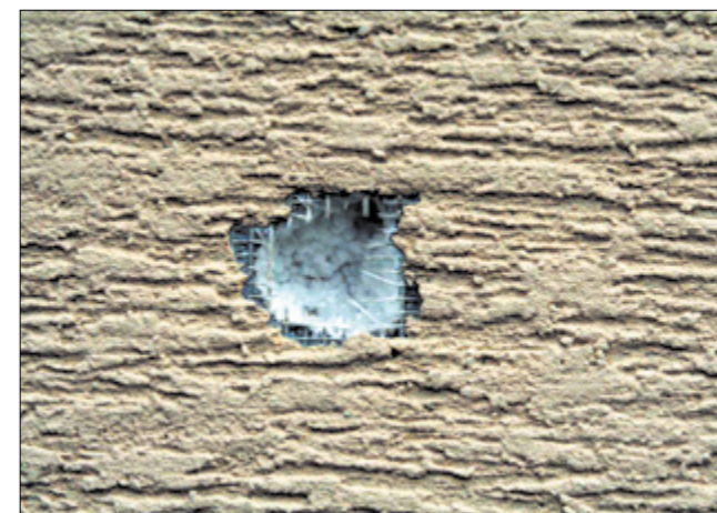
Uszkodzenia mechaniczne Fot. archiwum SSO
