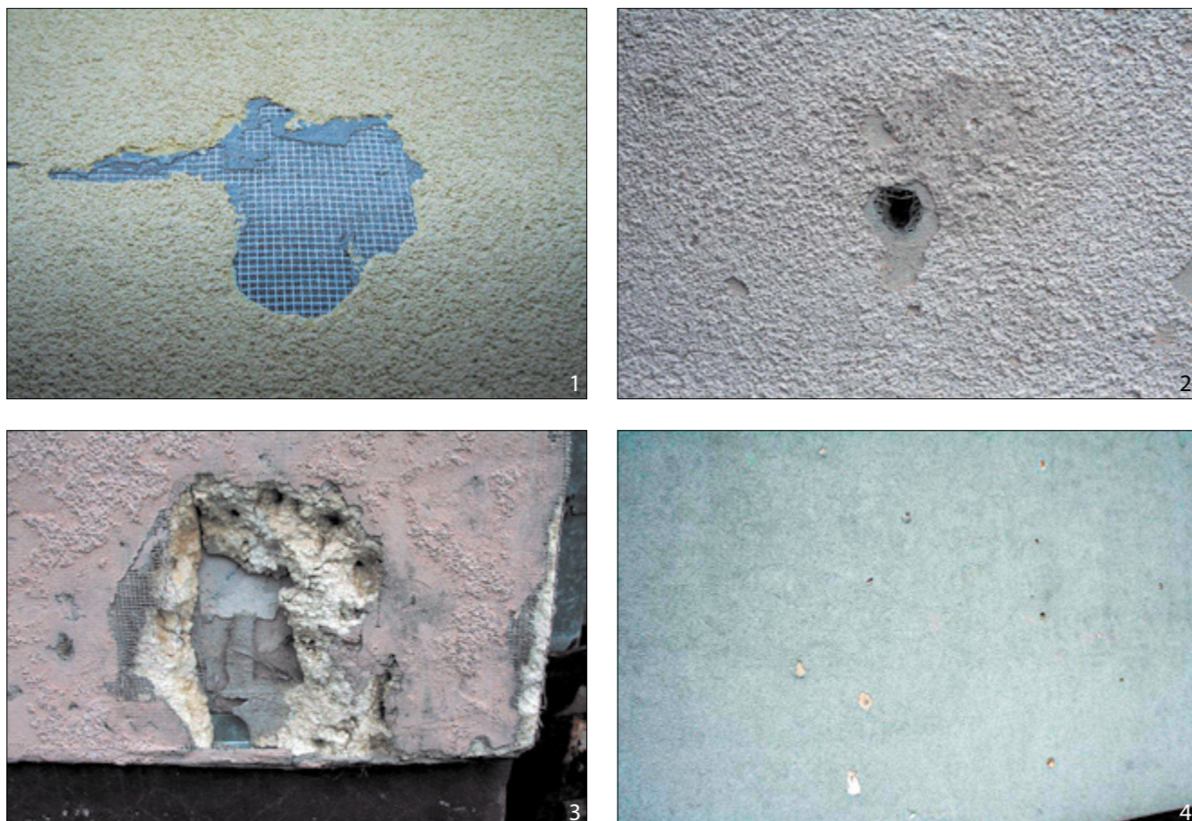
Usterki na ocieplonych elewacjach wymagające naprawy: 1 – odspojenie w warstwie zbrojonej, 2 – uszkodzenie mechaniczne spowodowane przez uderzenie twardym przedmiotem, 3 – uszkodzenie mechaniczne spowodowane przez gradobicie, 4 – Uszkodzenia spowodowane przez gradobicie Fot. archiwum SSO
