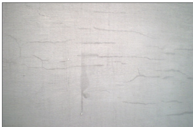
Pęknięcia na warstwie zbrojonej
