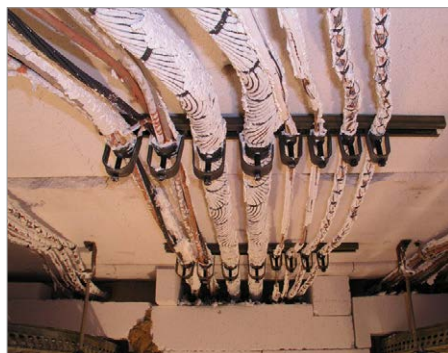
Zespół kablów po badaniu odporności ogniowej fot. BAKS
