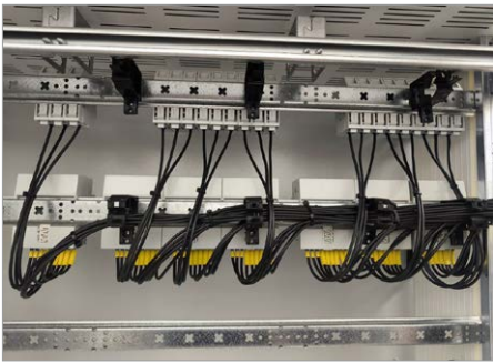
Fot. 2. Przykład ułożenia w powietrzu i wiązkach (zdjęcie wykonane od strony „pleców” rozdzielnic) fot. J. Wiatr, M. Orzechowski
