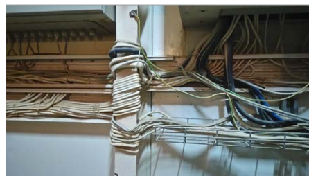
Fot. 1. Często w rozbudowywanych instalacjach liczba przewodów znacznie się powiększa – szkoda, że instalatorzy zapominają o podstawowych zasadach prowadzenia tego typu tras. Fot. K. Łukowiak
