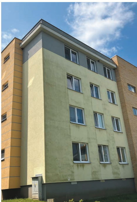
FOT. 1 Fragment elewacji północnej budynku położonego w północno-wschodniej Polsce. Widoczne porażenie biologiczne oraz poziome spękanie wyprawy wierzchniej będące wynikiem splotu kilku określonych błędów wykonawczych w montażu ocieplenia ETICS; fot.: autor
