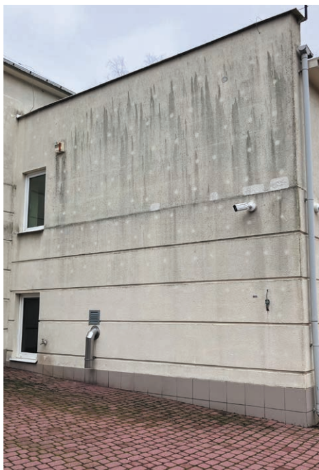
FOT. 2 Fragment elewacji południowej budynku położonego we wschodniej Polsce. Widoczne zabrudzenia, porażenie biologiczne, liniowe (w miejscach spoin między płytami izolacyjnymi) i punktowe (efekt biedronki) wybarwienia spowodowane mostkami termicznymi; fot.: autor
