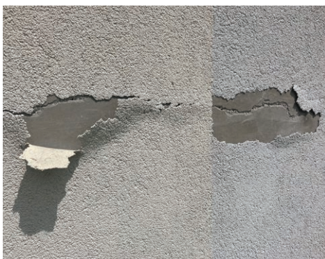
FOT. 3 Fragment elewacji południowej budynku położonego w zachodniej Polsce. Widoczne spękanie warstwy zbrojonej oraz odspojenia tynku cienkowarstwowego będące skutkiem utraty przyczepności systemu ociepleniowego do podłoża; fot.: autor
