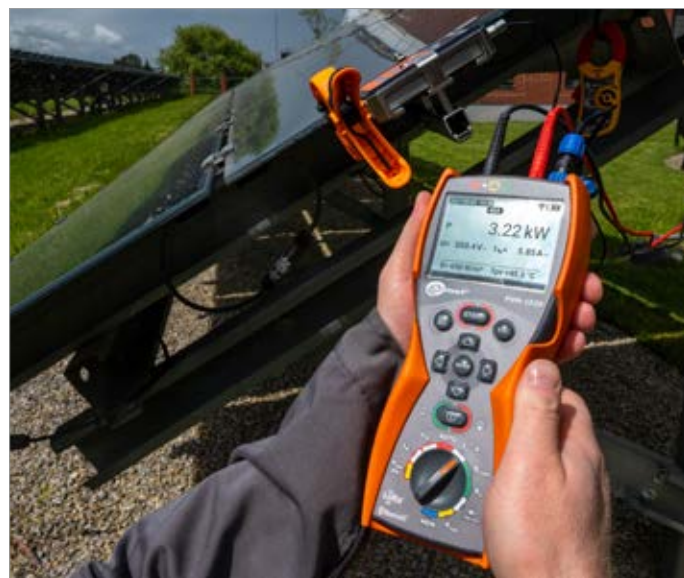
Rys. 2. Pomiary paneli fotowoltaicznych miernikiem Sonel PVM-1020
