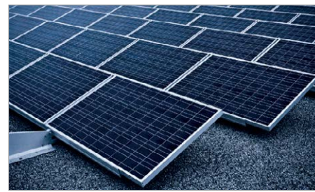
Bateria paneli fotowoltaicznych na dachu
