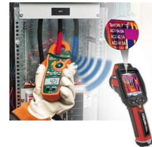
Fot. 3. Przykład niesymetrycznego obciążenia instalacji trójfazowej fot. Flir
