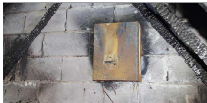
Rys. 3b. Początek pożaru domu spowodowany uszkodzeniem falownika [16]
