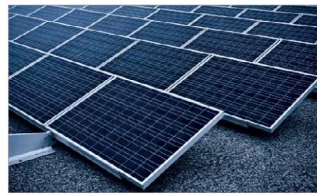
Bateria paneli fotowoltaicznych na dachu
