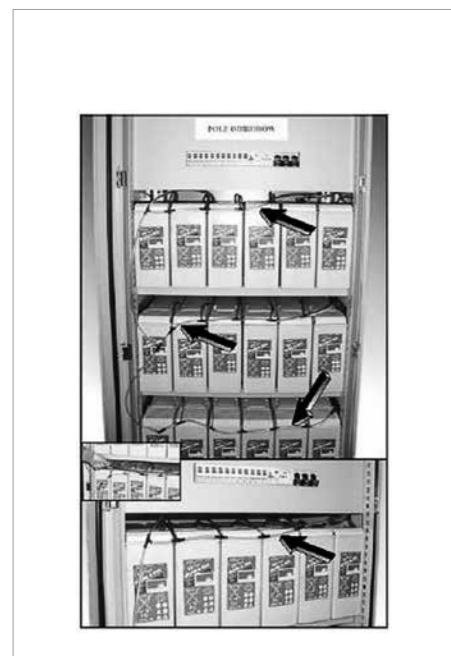
Rys. 12. Szafa bateryjna wyposażona w system rur do odprowadzenia wodoru (H 2 ) rys. J. Wiatr
