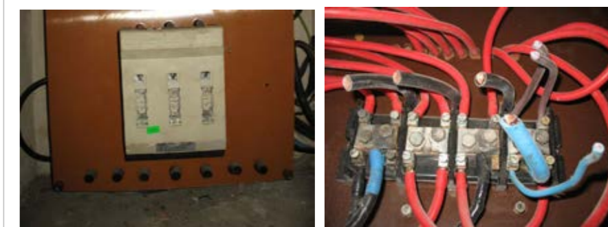
Fot. 4. Przykład zaobserwowania podwyższonej temperatury za tablicą bakelitową i przyczyny zidentyfikowane przy demontażu tablicy [7]
