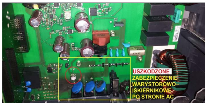
Rys. 3a. Uszkodzony falownik PV [1]
