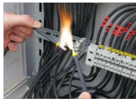
Rys. 1. Skutki zwarcia gałęzi paneli PV zainstalowanych na dachu obiektu fot. J. Wiater
