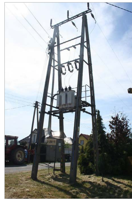
Rys. 3. Zdjęcie słupowej stacji transformatorowej starego typu – stacji napowietrznej słupowej na żerdziach ŻN w układzie podwójnego A rys. W. Dołęga
