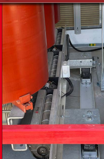
Fot. 2. Wraz ze wzrostem zapotrzebowania na energię rośnie potrzeba efektywnego chłodzenia transformatorów, które w trakcie pracy generują znaczne ilości ciepła
