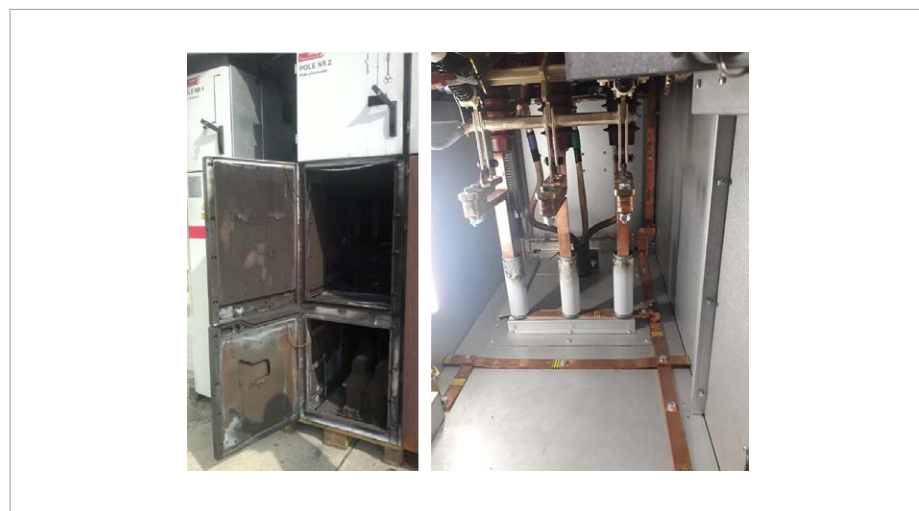
Rys. 5. Widok rozdzielnic e²ALPHA po próbach łukowych 31,5 kA, 1 s oraz widok przedziału przyłączonego rozdzielnic e²ALPHA po zwarciu łukowym i zadziałaniu zabezpieczenia łukoochronnego ARC rys. W. Chmielak
