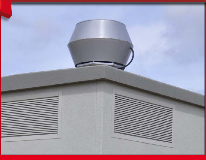
Fot. 1. Bliskie umieszczenie kratki wentylacyjnych i wentylatora wyciągowego powoduje ograniczoną skuteczność wentylacji
