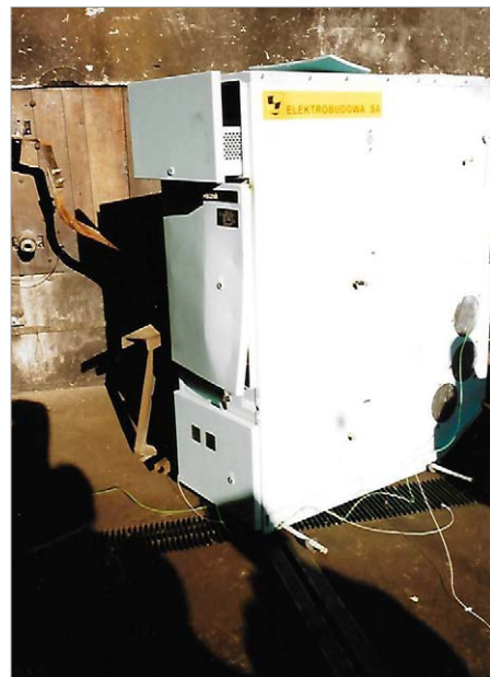
Rys. 10. Zdjęcie ilustrujące odkształcenia osłony pola rozdzielczego po badaniach odporności na wewnętrzny łuk zwarciaowy [5]
