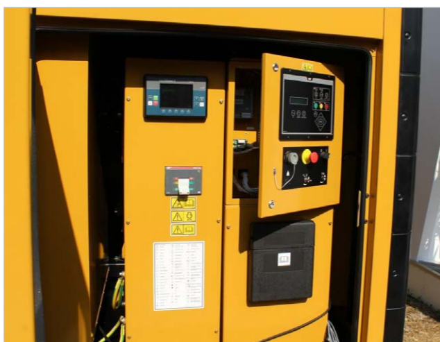
Fot. 1. Układ sterowania zespołu prądotwórczego zabudowanego w kontenerze
