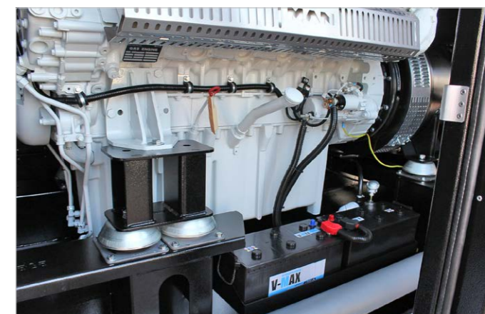
Fot. 2. Przykład wibroizolatora mocującego układ napędowy zespołu kogeneracyjnego
