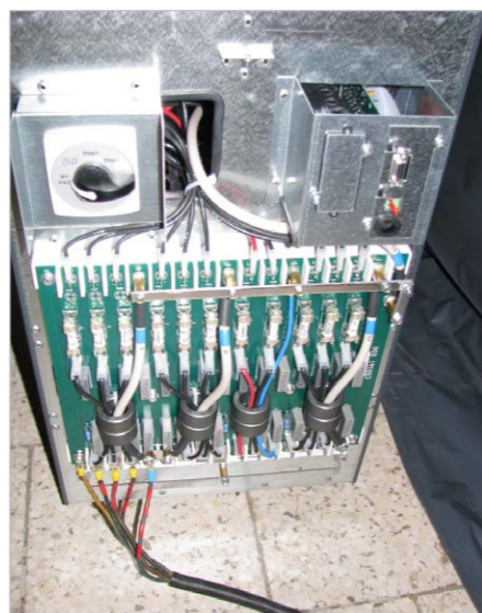
Fot. 1. Przykład zabezpieczeń obwodów wejściowych i wyjściowych zasilacza UPS o mocy 20 kVA
