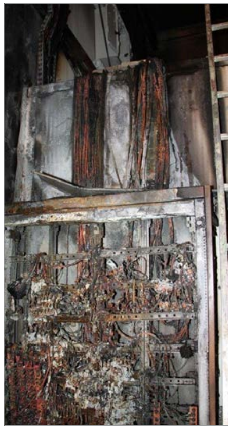
Rys. 5. Częściowo spalony obiekt w wyniku błędnego doboru ogranicznika przepięć fot. J. Wiater
