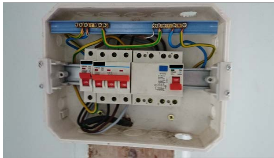
Fot. 2. Przykład, jak nie instalować rozdzielnic i aparatury modułowej fot. K. Kuczyński
