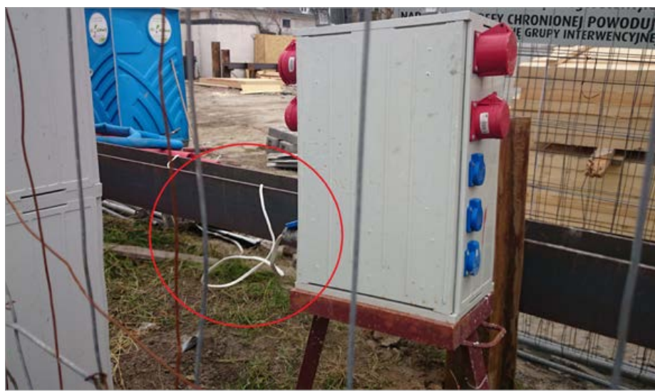
Fot. Przykład, jak nie powinna być eksploatowana rozdzielnica budowlana fot. JT
