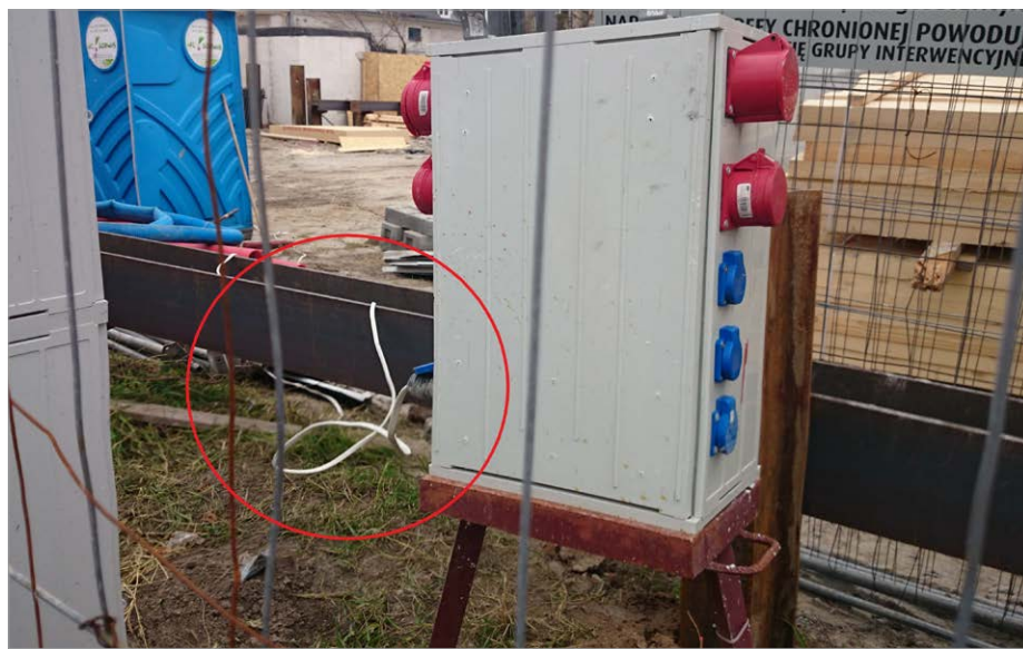
Fot. Przykład, jak nie powinna być eksploatowana rozdzielnica budowlana fot. JT
