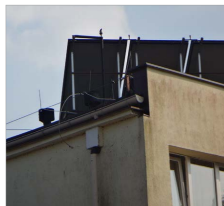
Rys. 2. Panele PV zamontowane powyżej poziomu projektowanej ochrony odgromowej fot. J. Wiater
