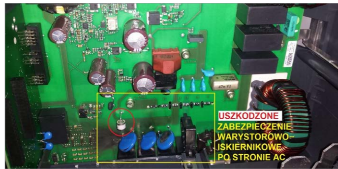
Rys. 3a. Uszkodzony falownik PV [1]
