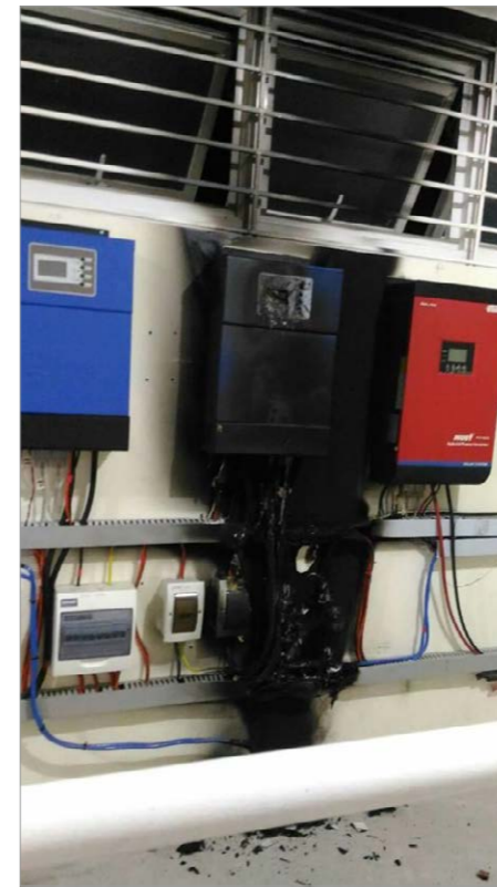
Fot. 9. Skutki niewłaściwego działania zabezpieczeń instalacji fotowoltaicznej – pożar falownika [5]
