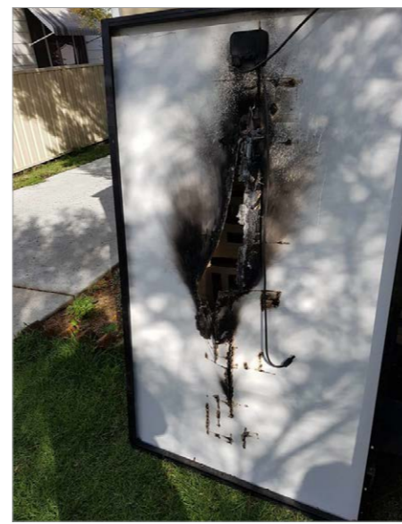
Fot. 7. Skutki pożaru panelu PV – widok z tyłu [5]
