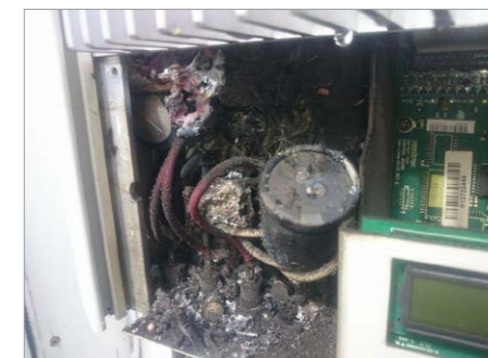
Fot. 10. Wewnętrzny pożar falownika instalacji PV (w części DC) [5]
