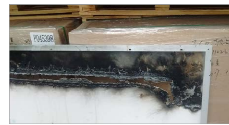
Fot. 8. Skutki zwarcia w panelu PV i powstałego w jego wyniku pożaru – widok z tyłu [5]
