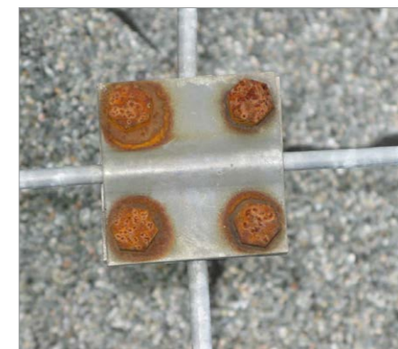
Rys. 3. Korozja kontaktowa powstała w wyniku niewłaściwego doboru materiałów [1]
