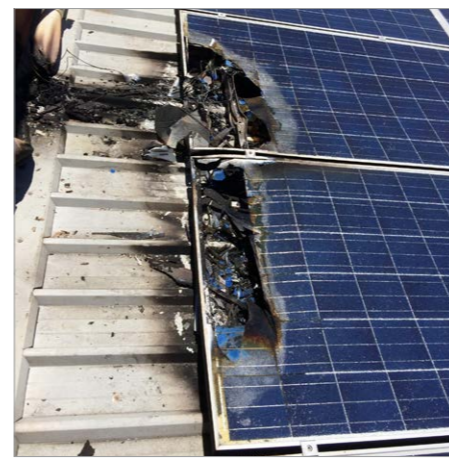
Fot. 6. Skutki pożaru spowodowanego prawdopodobnie przez przepięcie na wyjściu DC instalacji PV [5]
