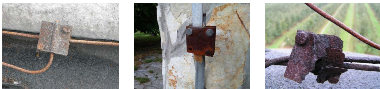
Rys. 1. Przykłady skorodowanych złączy instalacji piorunochronnej [1]
