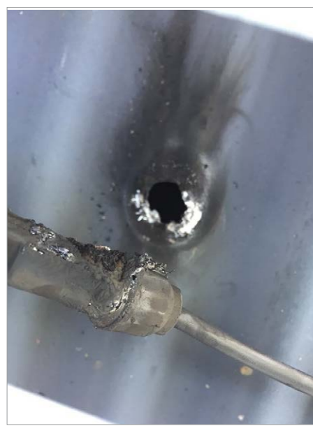
Fot. 20. Przebite poszycie dachowe i przewód instalacji PV w wyniku doziemnego wyładowania piorunowego [5]
