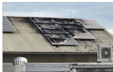
Fot. 3. Skutki pożaru przykładowej instalacji fotowoltaicznej [5]
