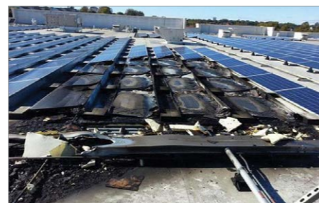
Fot. 5. Skutki pożaru instalacji PV oraz okablowania na dachu dużej hali magazynowo-handlowej [5]
