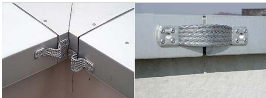
Rys. 7. Połączenia elastyczne między obróbką metalową attyki za pomocą taśm stalowych lub aluminiowych [4]
