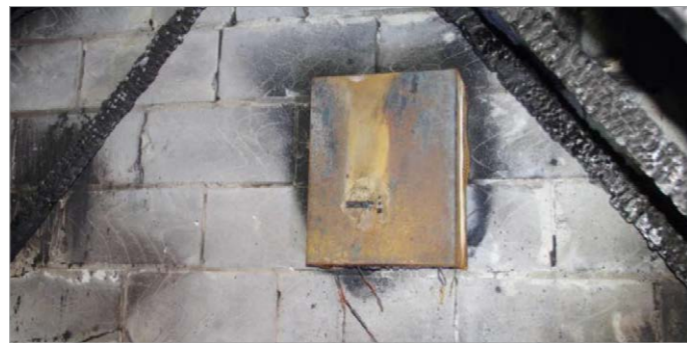
Rys. 3b. Początek pożaru domu spowodowany uszkodzeniem falownika [16]
