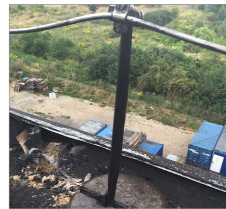
Rys. 3. Obiekt uszkodzony w wyniku niezachowania wymaganych odstępów separacyjnych i niekontrolowanych przeskoków iskrowych od instalacji odgromowej [1]
