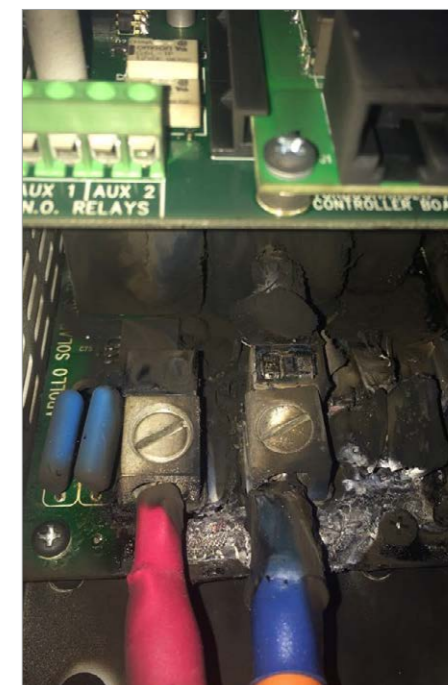
Fot. 11. Skutki przepięcia i następującego po nim zapłonu łuku po stronie DC falownika w instalacji PV – zwęglenie części płytki PCB [5]
