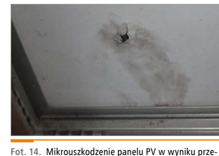
Fot. 14. Mikrouszkodzenie panelu PV w wyniku przebicia izolacji pomiędzy metalową konstrukcją nośną a ogniwem PV – widok z tyłu [zdjęcie JW]
