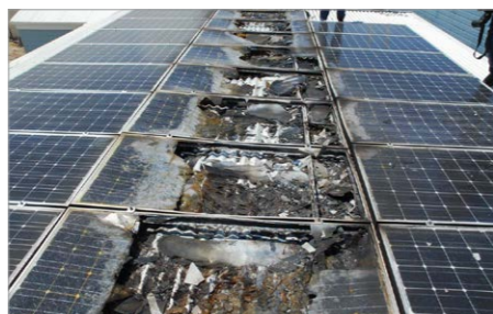
Fot. 4. Skutki pożaru całego stringu w instalacji fotowoltaicznej [5]
