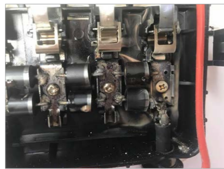
Fot. 16. Uszkodzenie diod bocznikujących ogniwa PV i częściowe ich zwęglenie i nadpalenie kabla w wyniku grzania się wyjść DC panelu PV [5]
