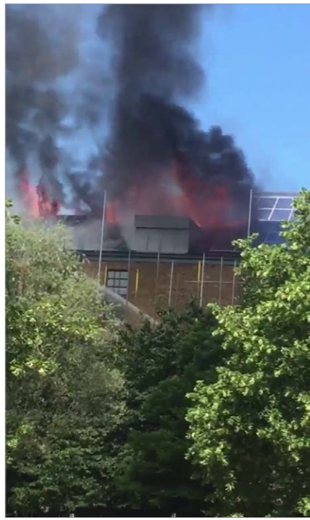
Fot. 1. Pożar instalacji fotowoltaicznej zainstalowanej na dachu kamienicy [3]
