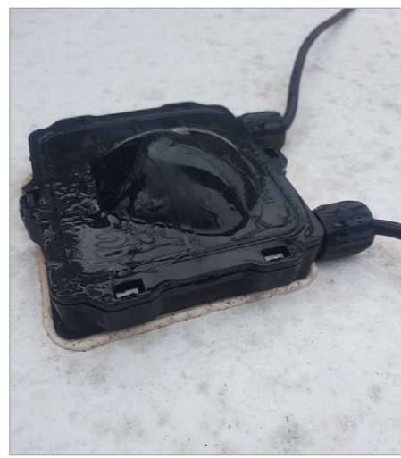
Fot. 17. Przetopiona puszka z diodami bocznikującymi – uszkodzenie powstało w wyniku bardzo silnego grzania się diod spowodowanego pracą na zwarcie części panelu PV [5]
