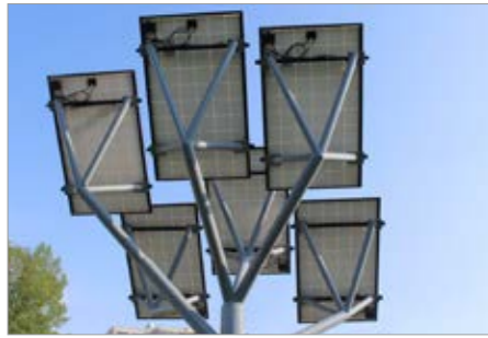
Fot. 4. Przykład wolnostojącej instalacji PV w świetle widzialnym fot. K. Kuczyński, G. Dymny
