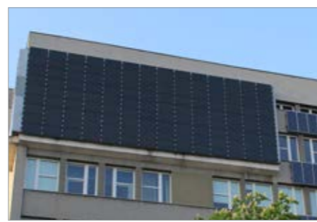
Fot. 1. Instalacja fotowoltaiczna na fasadzie budynku fot. K. Kuczyński, G. Dymny
