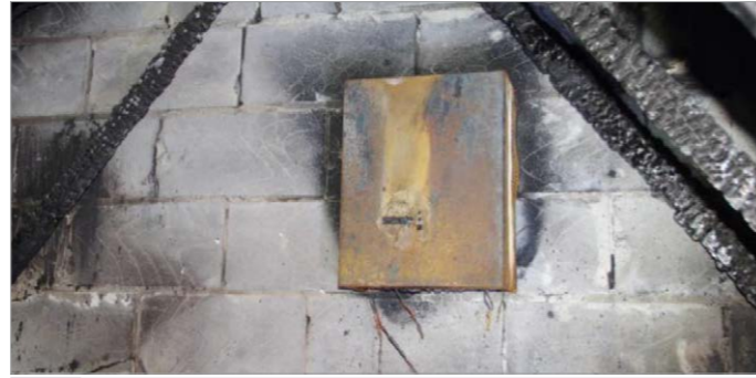
Rys. 3b. Początek pożaru domu spowodowany uszkodzeniem falownika [16]
