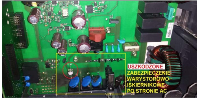
Rys. 3a. Uszkodzony falownik PV [1]
