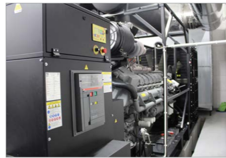
Układ sterowania zespołu prądotwórczego o mocy 2,2 MVA fot. JT
