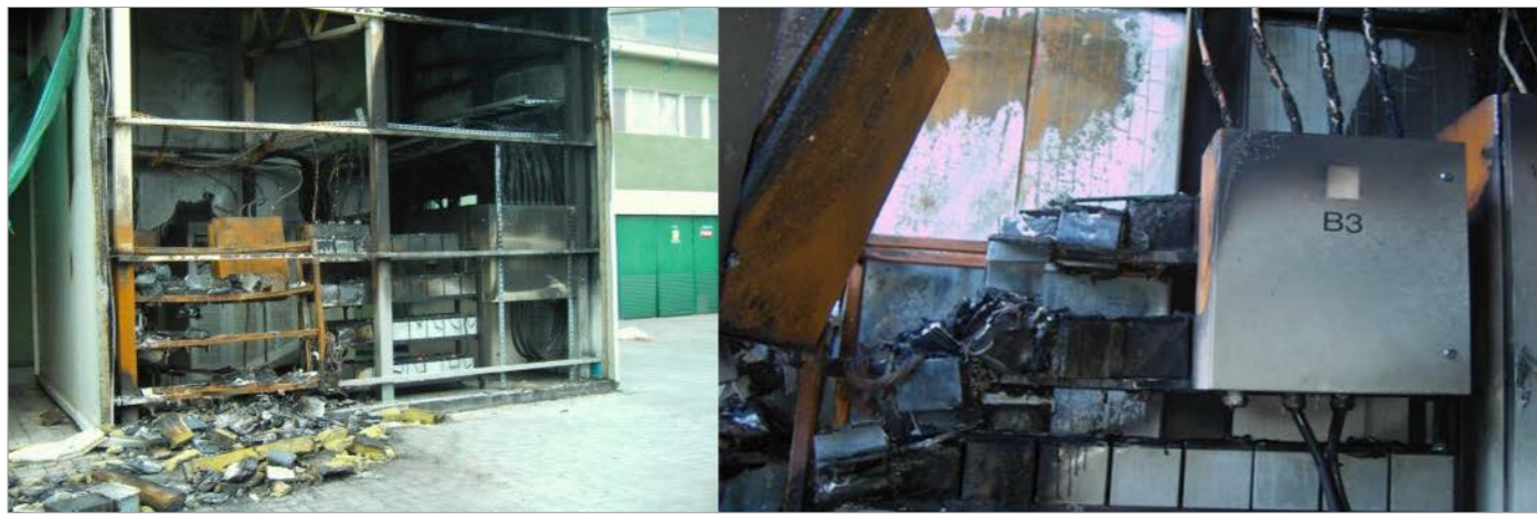
Fot. 1. Pomieszczenie baterijne zasilacza UPS po wybuchu wodoru spowodowanego prądem zwarciovym fot. M. Orzechowski, J. Wiatr
