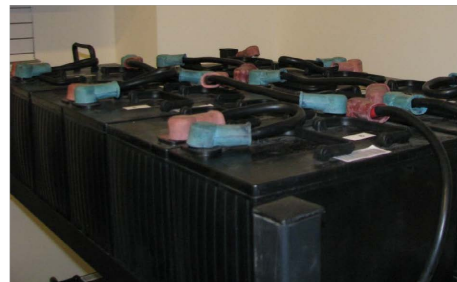
Fot. 1. Przykład układu połączeń zewnętrznych baterii akumulatorów na stojaku fot. JT
