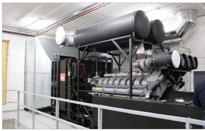
Fot. 1. Przykładowe rozwiązanie umieszczenia zespołu w pomieszczeniu fot. JT
