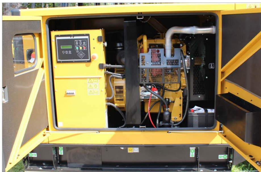
Fot. 1. Przykład zespołu prądotwórczego w obudowie wyciszzonej fot. JT
