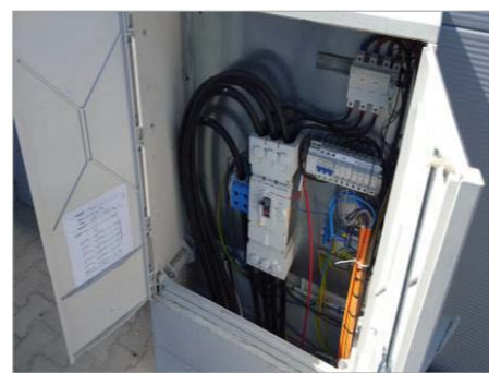
Rys. 1. Aparat elektryczny wykonawczy z możliwością ręcznego wyłączenia zasilania budynku w energię elektryczną źródło: oprac. własne
