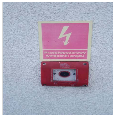
Rys. 2. Przycisk uruchamiający zdalnie przeciwpożarowy wyłącznik prądu bez sygnalizacji stanu zadziałania aparatu źródło: oprac. własne
