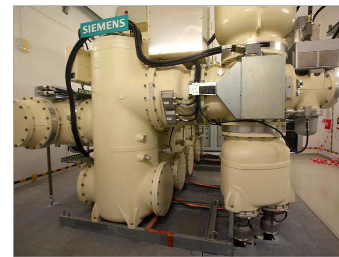
Rys. 9. Rozdzielnica 15 kV prefabrykowana, dwuczłonowa w izolacji SF 6 , czterosekcyjna, 50-polowa posiadająca 4 pola transformatorowe, 2 pola sprężelki podłużnego, 4 pola zespołów uziamiających i 40 pól liniowych (odpływowych). Producent: Siemens [7]
