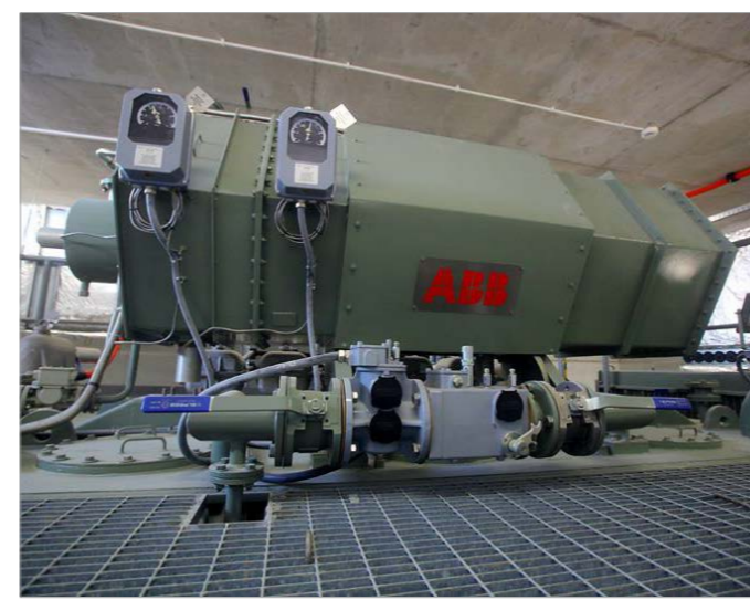
Rys. 8. Transformator mocy trójuzwojeniowy 110/15/15 kV o mocy 40/20/20 MVA. Masa całkowita 49 000 kg. Objętość oleju transformatorowego 15170 l. Producent: ABB [7]
