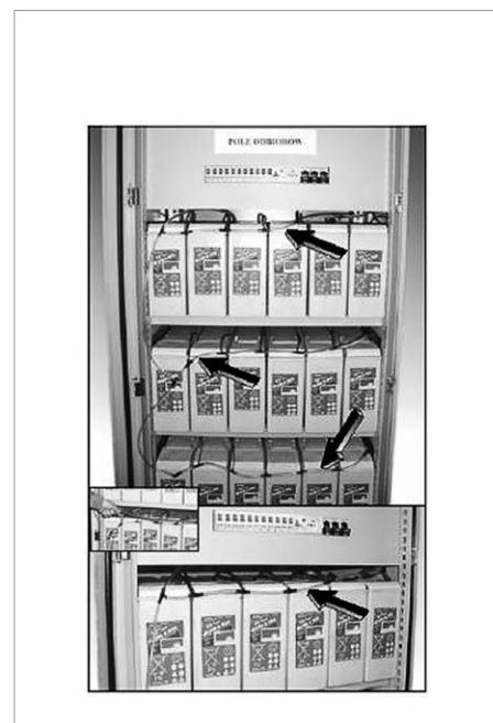
Rys. 12. Szafa bateryjna wyposażona w system rur do odprowadzenia wodoru (H 2 ) rys. J. Wiatr
