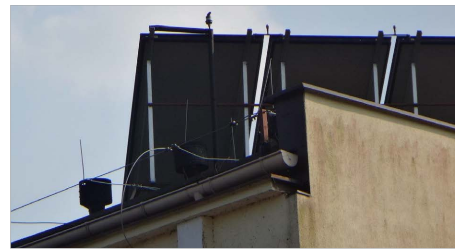
Rys. 2. Panele PV zamontowane powyżej systemu ochrony odgromowej fot. J. Wiater
