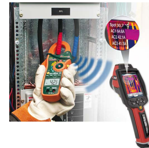
Fot. 3. Przykład niesymetrycznego obciążenia instalacji trójfazowej fot. Flir
