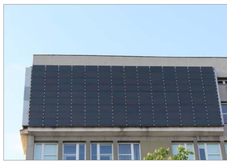
Fot. 5. Instalacja fotowoltaiczna na fasadzie budynku w świetle widzialnym [7]
