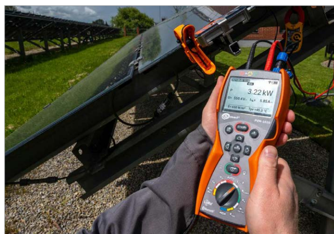
Badanie instalacji fotowoltaicznej miernikiem Sonel PVM-1020
