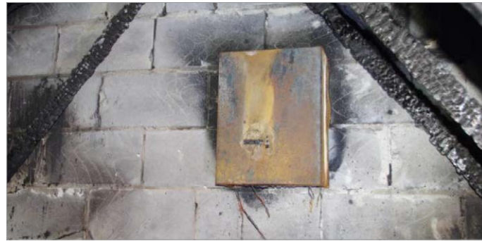
Rys. 3b. Początek pożaru domu spowodowany uszkodzeniem falownika [16]
