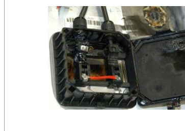
Fot. 13. Przykład skutków działania łuku elektrycznego w puszcze przyłączeniowej modułu PV [9]
