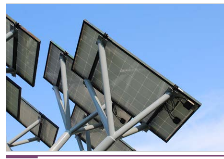
Fot. 10. Widoczne w świetle widzialnym odbicia na szklanych nierównościach spodniej strony panelu PV [7]
